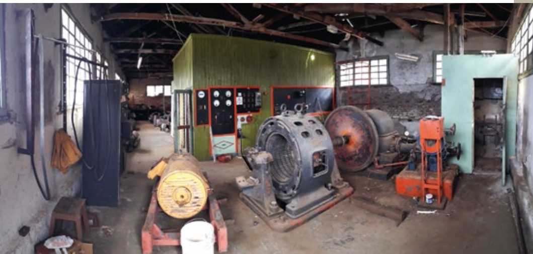
Turbina hidráulica y generador eléctrico | Hydraulic turbine and electric generator
